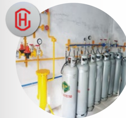
Hệ Thống Gas Nhà Bếp Gas system
