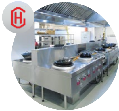
Bếp Công Nghiệp Industrial kitchen
